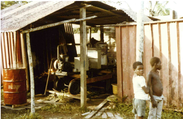
Abb.10: Holzkohle-Gasgenerator im Instituto Matia Mulumba (Buenaventura, Kolumbien). Links im Bild die Tonne, in der die Holzkohle durch die Motorabgase getrocknet wird.
