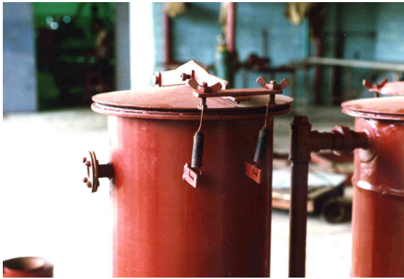
Abb. 22: Verschlussdeckel eines Generatorkessels (Cali, Kolumbien 1990)
